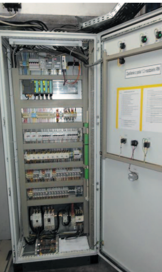
Szafa sterownicza taśmociągu nr 3
